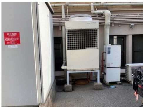
旧空調室外機+温水ボイラ
